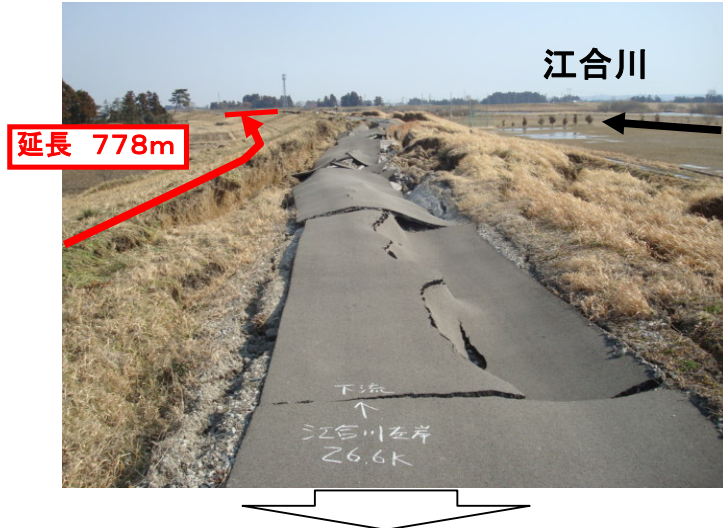
3月11日の堤防被害状況。 堤防の亀裂と沈下。
