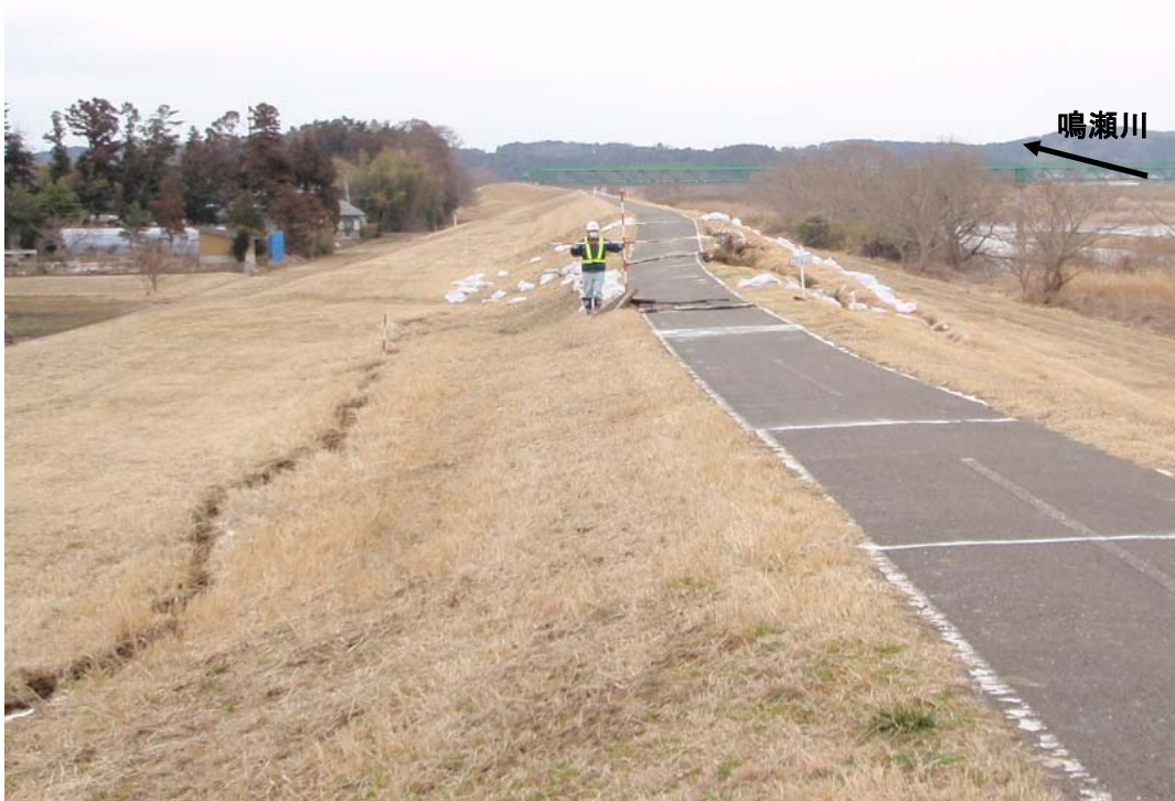
3月21日堤防被害状況 堤防沈下・亀裂・斜面の崩れ
