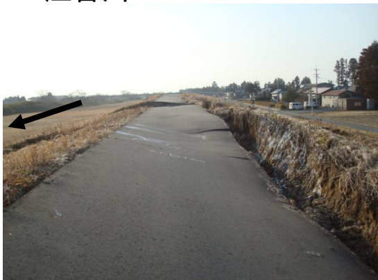
江合川左岸 美里町北浦(21.0k) 堤防の沈下
