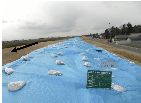
江合川左岸 美里町北浦(21.0k) 応急対策後 3月15日 シート張り完了
