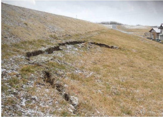
北上川右岸 登米市中田町上沼(45.4k+100m) 堤防の亀裂(堤防の居住側の堤防斜面)
