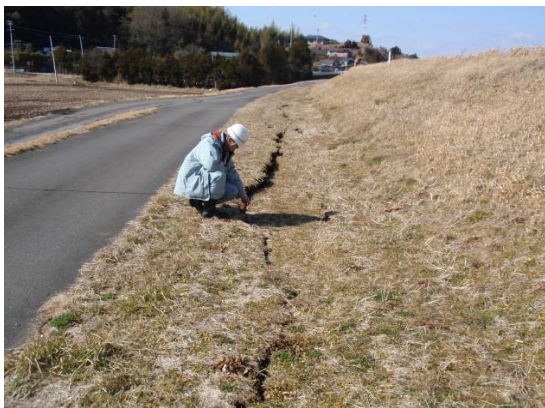
吉田川右岸 松島町竹谷(7.2k) 堤防の亀裂(堤防の居住側の堤防小段)
