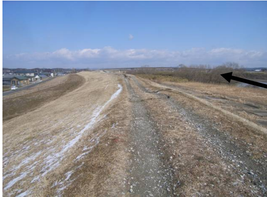
鳴瀬川右岸 大崎市鹿島台木間塚(13.7k) 堤防の亀裂
