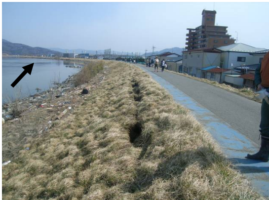
旧北上川右岸 石巻市水押(7.8k) 堤防の亀裂
