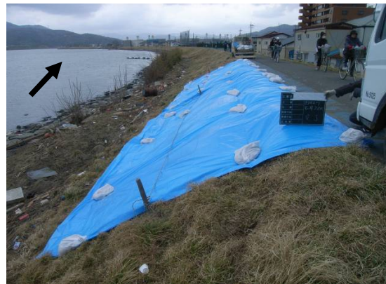
旧北上川右岸 石巻市水押(7.8k) 応急対策後 3月15日 シート張り完了
