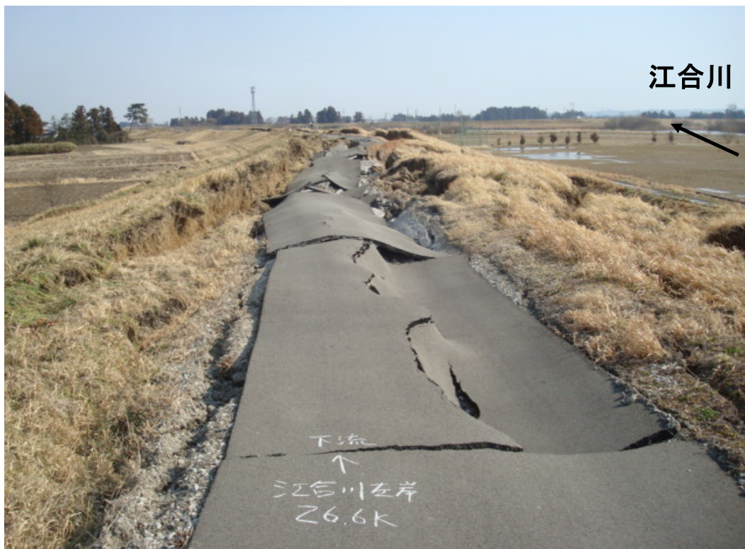
江合川左岸26.6k付近(堤防亀裂・沈下)
