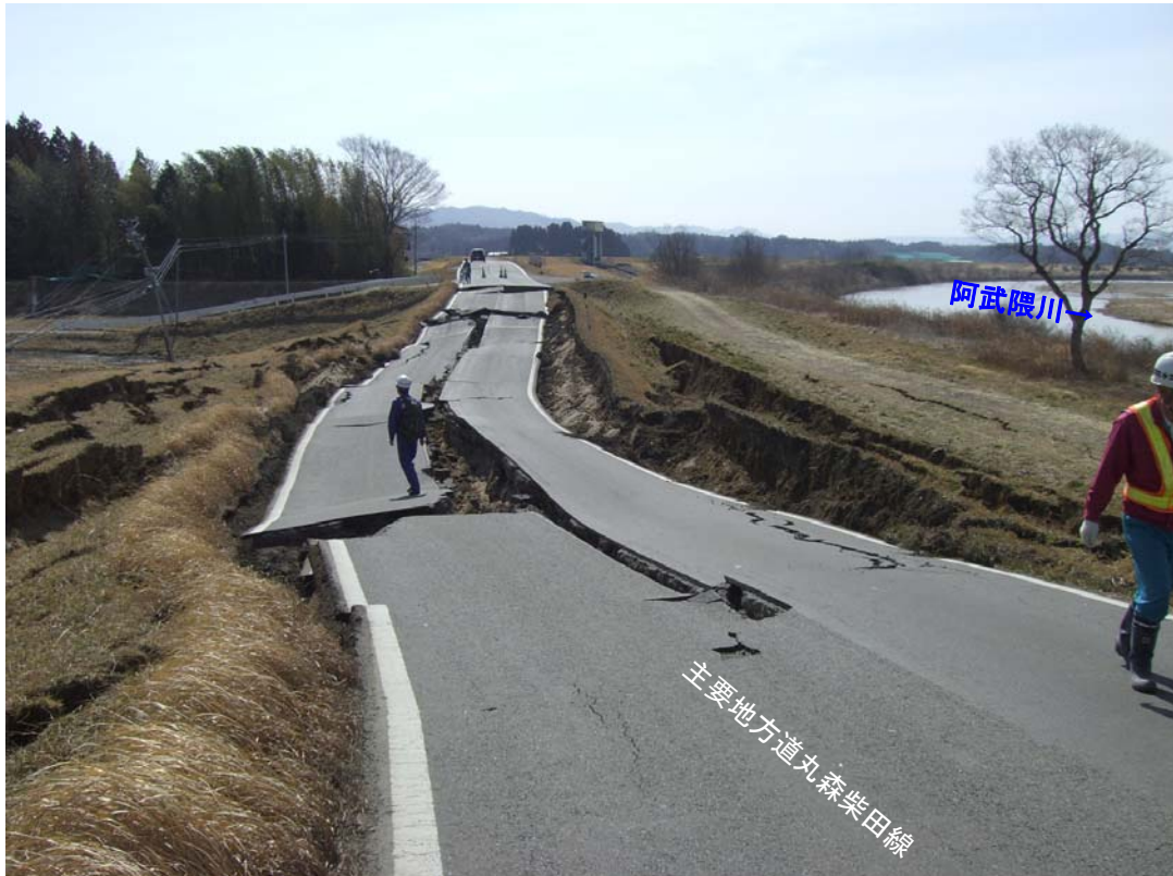
堤防陥没箇所を下流側から望む(主要地方道丸森柴田線天端兼用)
