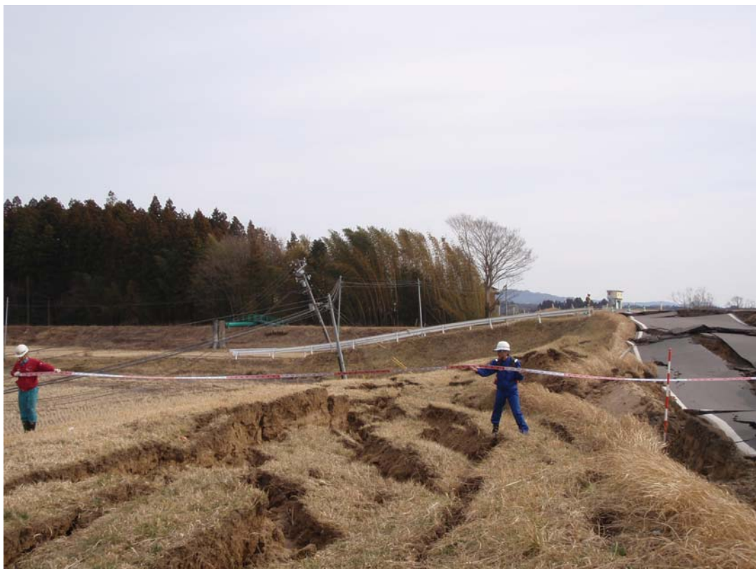
堤防陥没箇所川裏側法面変状範囲計測
