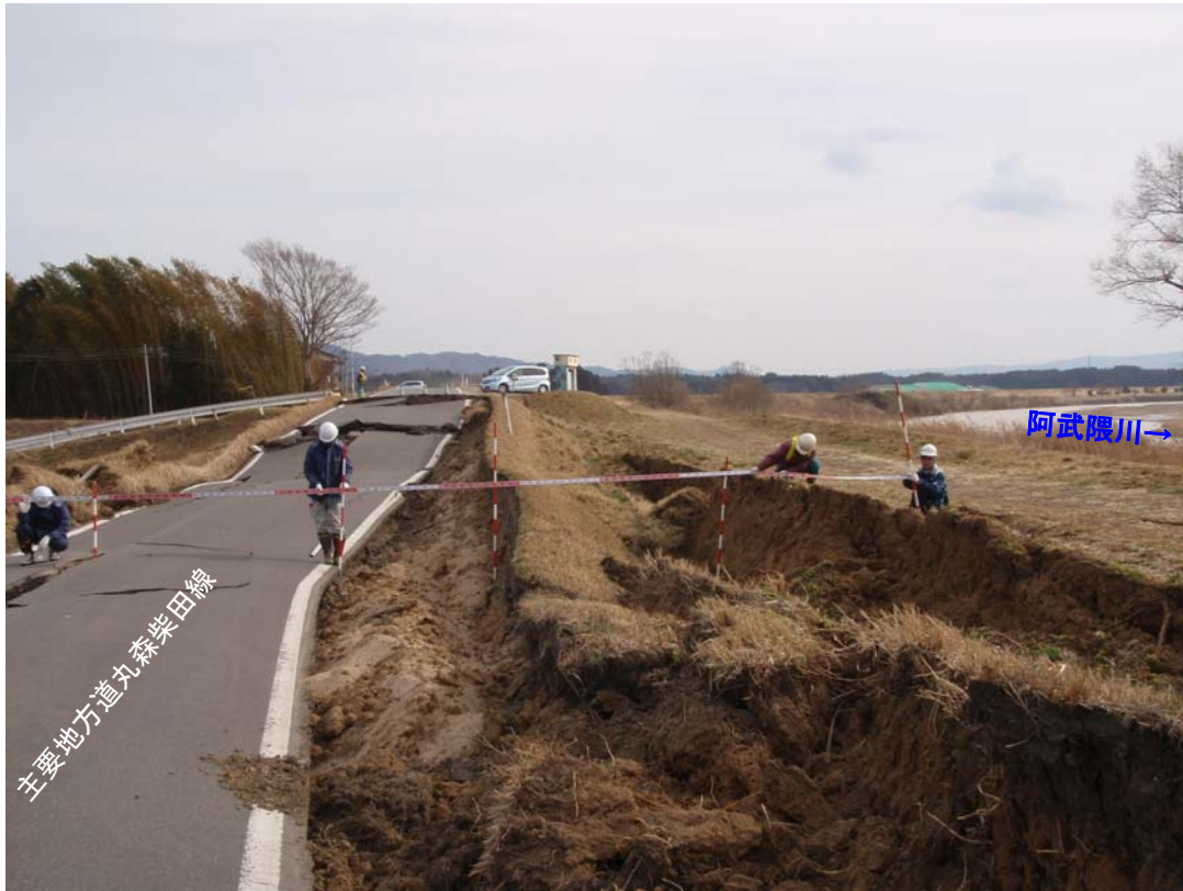
堤防陥没箇所川表側法面変状範囲計測
