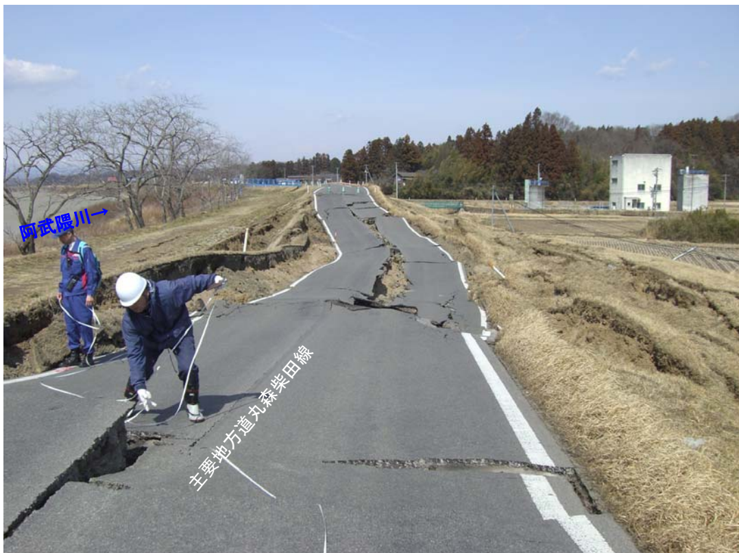
堤防陥没箇所を上流側から望む
