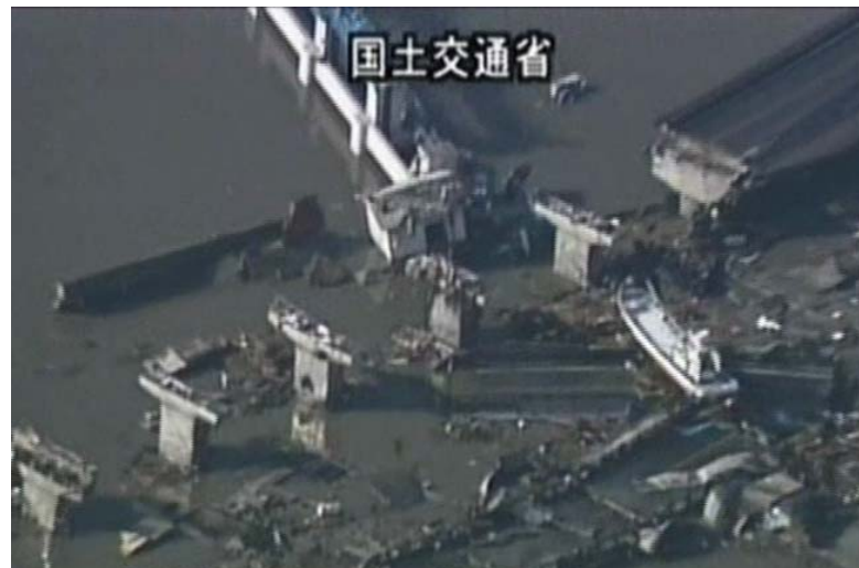
【写真④ 国道45号】(ヘリコプターによる上空画像) 落橋: 歌津大橋(南三陸町歌津町字伊里前地内)
