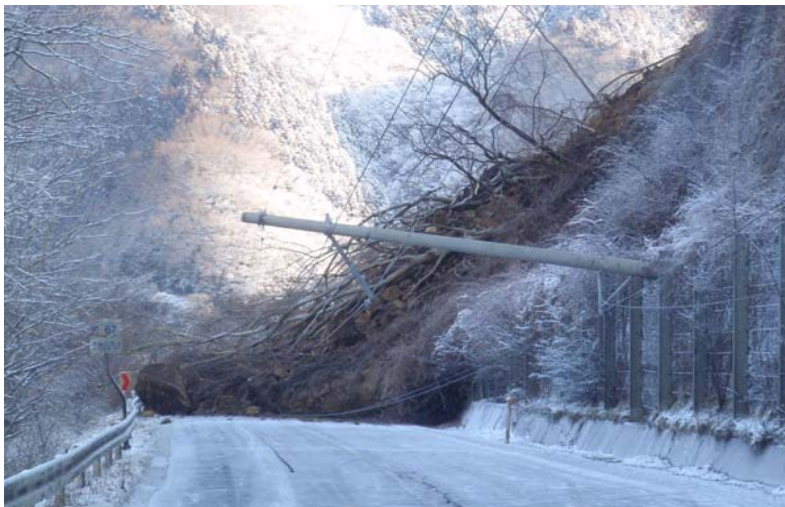
【写真③ 国道45号】法面崩落(石巻市河北町大字成田地内) 石巻方面から気仙沼方面(北方向)を撮影
