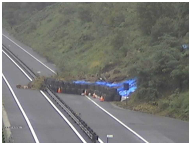
▲応急復旧作業前
