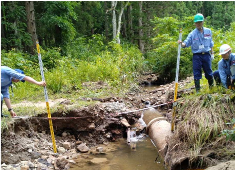
先遣調査班⑥一1 被災状況調査(山形県舟形町)
