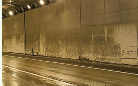
ひび割れ(側壁部)
