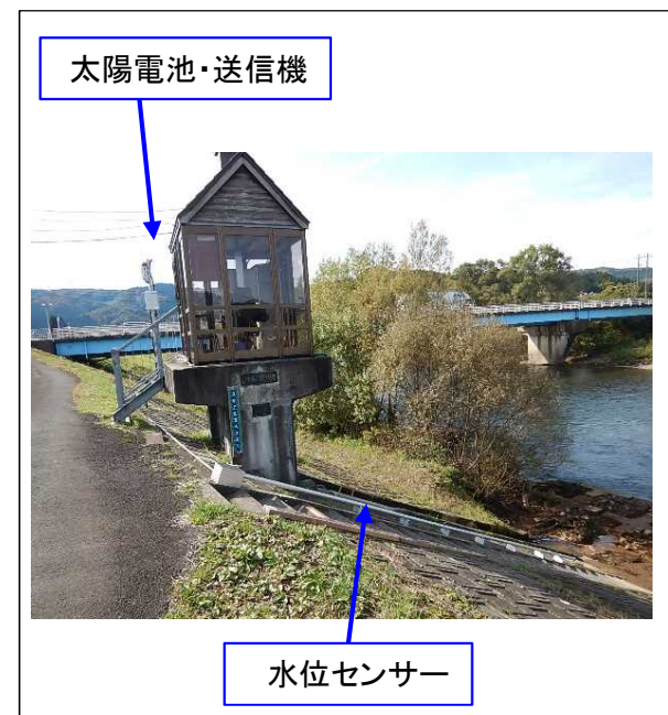
【危機管理型水位計設置事例】
