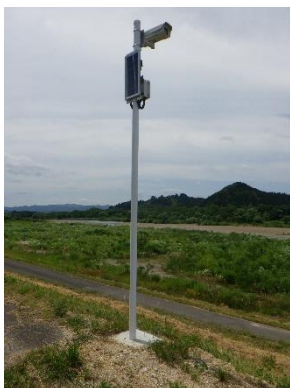
簡易型河川監視カメラ設置状況
