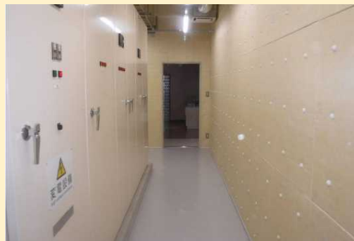
屋内に電気室を設置
