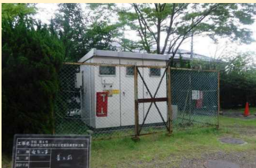
屋外にあった受変電設備
