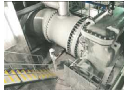
雨水ポンプの整備
