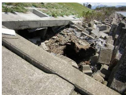
護岸の崩壊状況
