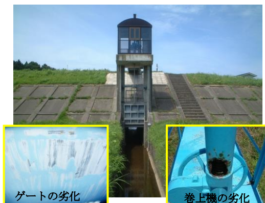
排水樋門と機械設備の劣化
