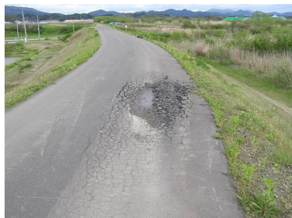
堤防天端の舗装の劣化状況
