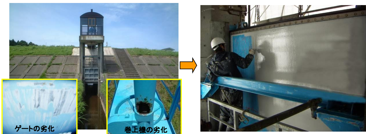
排水樋門と機械設備の劣化
