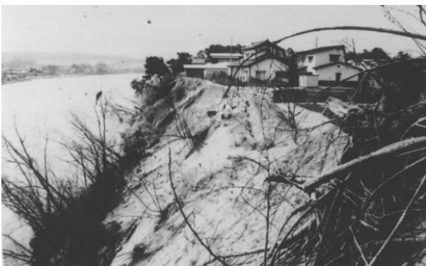
旧本庄市(尾花沢地区)の崩落した河岸
