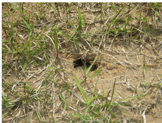
モグラ穴による堤防の損傷
