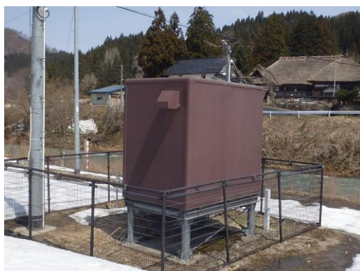
水位観測所（小川観測所）
