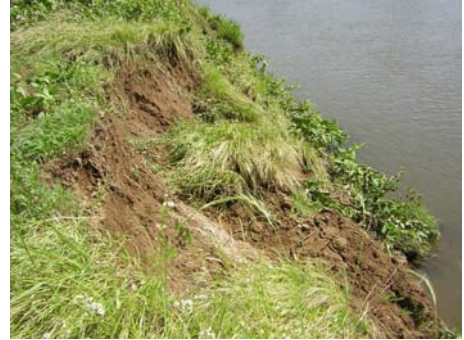
河岸崩壊の状況
