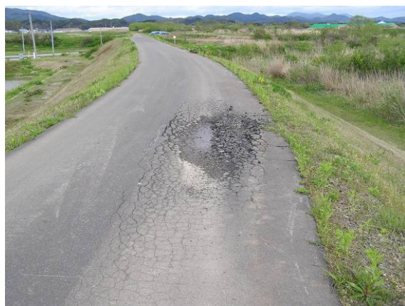
堤防天端の舗装の劣化状況
