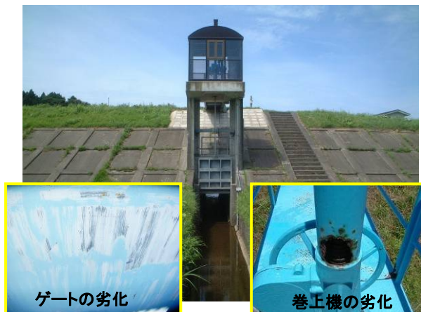
排水樋門と機械設備の劣化
