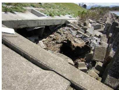
護岸の崩壊状況
