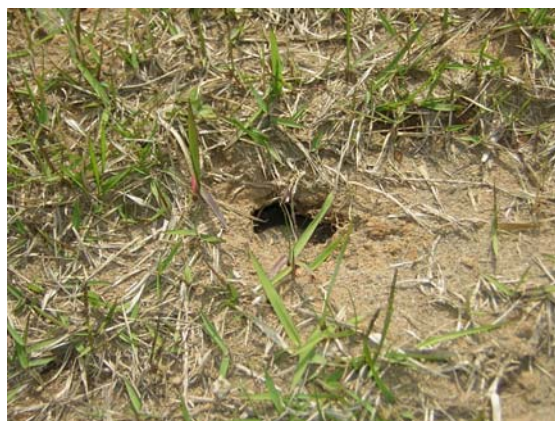
モグラ穴による堤防の損傷
