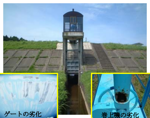
排水樋門と機械設備の劣化
