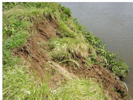
河岸崩壊の状況
