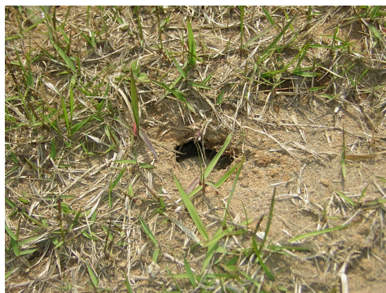
モグラ穴による堤防の損傷
