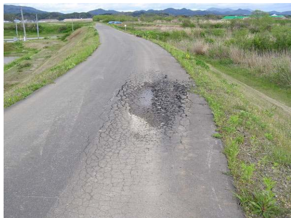
堤防天端の舗装の劣化状況
