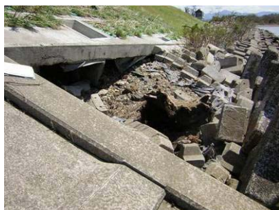
護岸の崩壊状況
