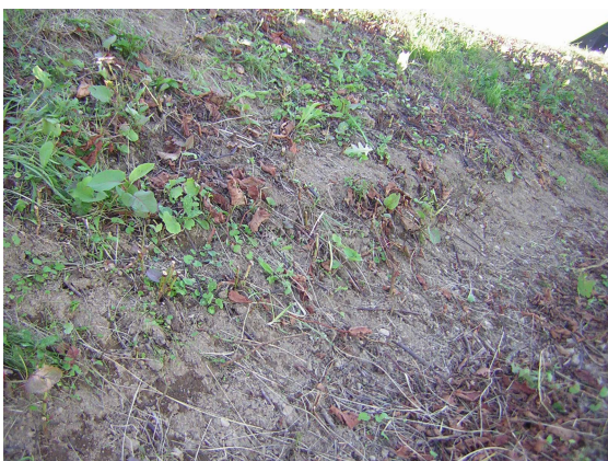
堤防の裸地化
