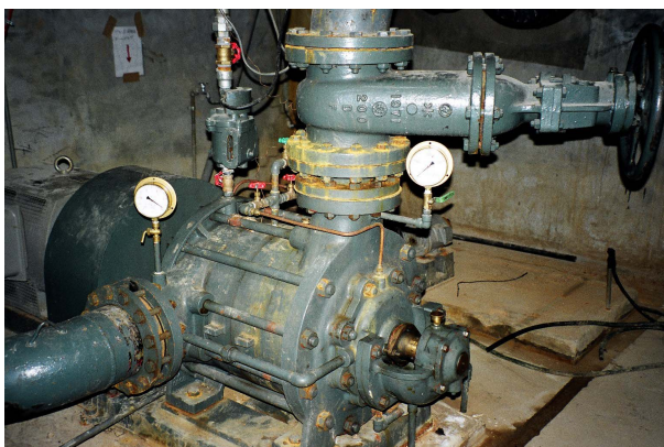
取水状況（玉ノ池揚水ポンプ）
