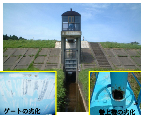
排水樋門と機械設備の劣化
