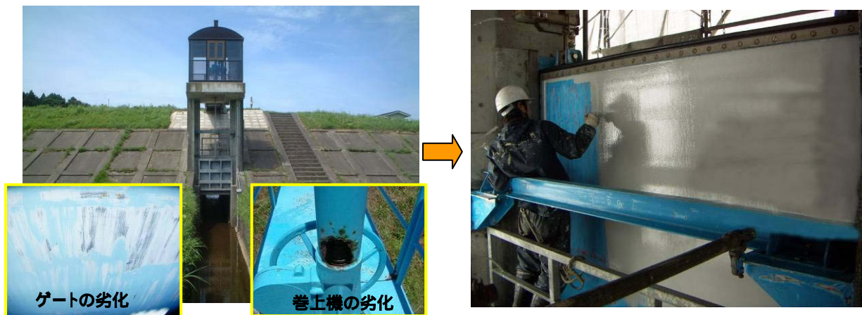
排水樋門と機械設備の劣化
