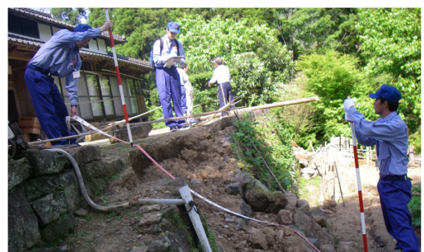
▲ 甲佐町からの要請でリエゾン自らが被災家屋の基礎調査を実施
