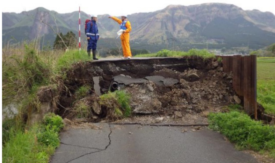
▲ 熊本県 乙女川堤防の被災調査（河川班）
