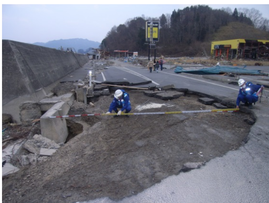
▲ TEC-FORCEの被災状況調査
