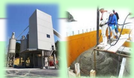
【牡鹿プラント(石巻市)】
