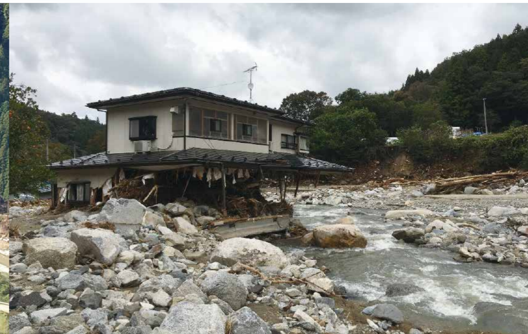
家屋の被災状況(五福谷川)
