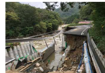
公共施設の被災状況(内川)
