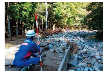
公共施設の被災状況調査(内川)
