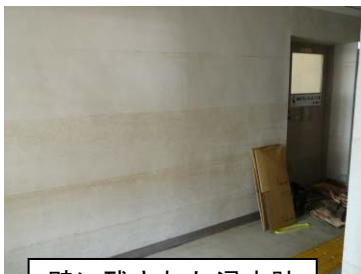
壁に残された浸水跡
