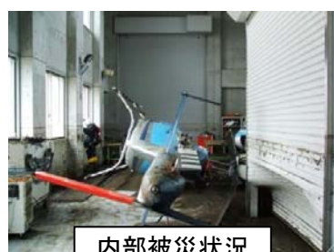
内部被災状況
