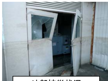
外部被災状況
