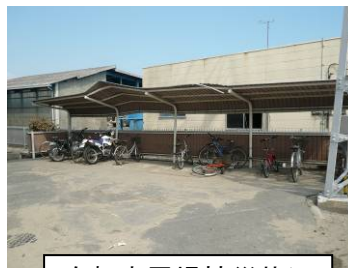
自転車置場被災状況
