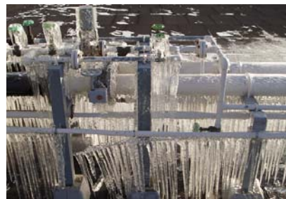
【配管の凍結破損】
