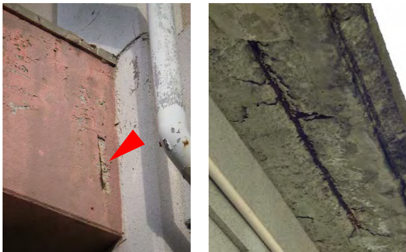
【外壁躯体の欠損・鉄筋の露出】
