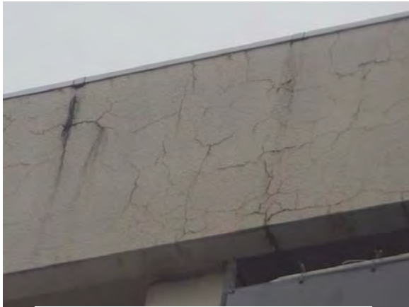
【外壁仕上げ材のひび割れ】
