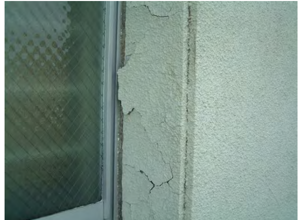
【外壁仕上げ材の浮き】
