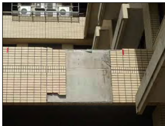
【外壁タイルの剥落】
