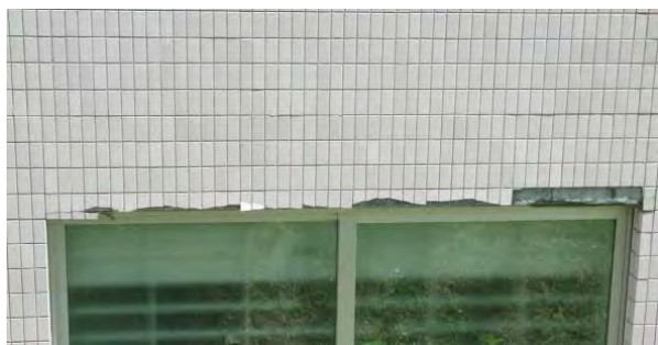
【窓上部のタイルの破損・落下】
