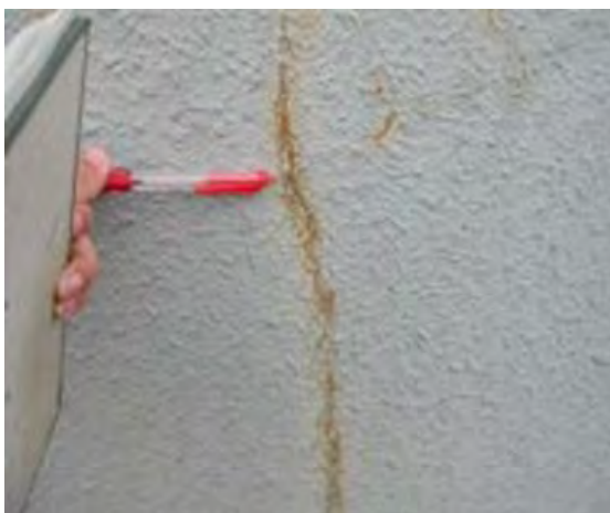
【外壁ひび割れ部の錆汁】
